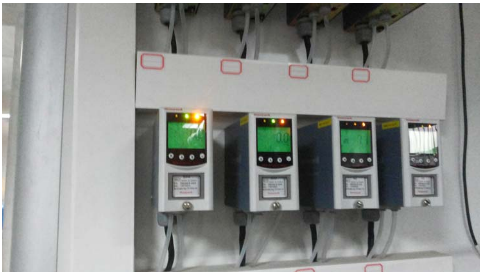
图 10-1 气瓶区气体泄漏检测报警装置
