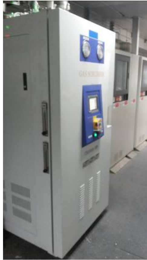
图 6-3 项目燃烧喷淋装置
