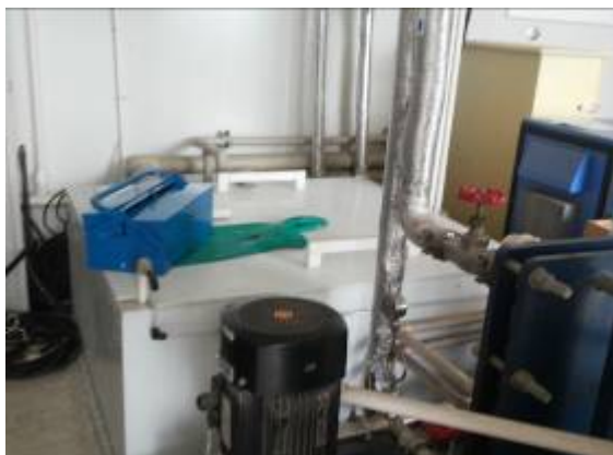
图 6-7 项目生产废水中和池
