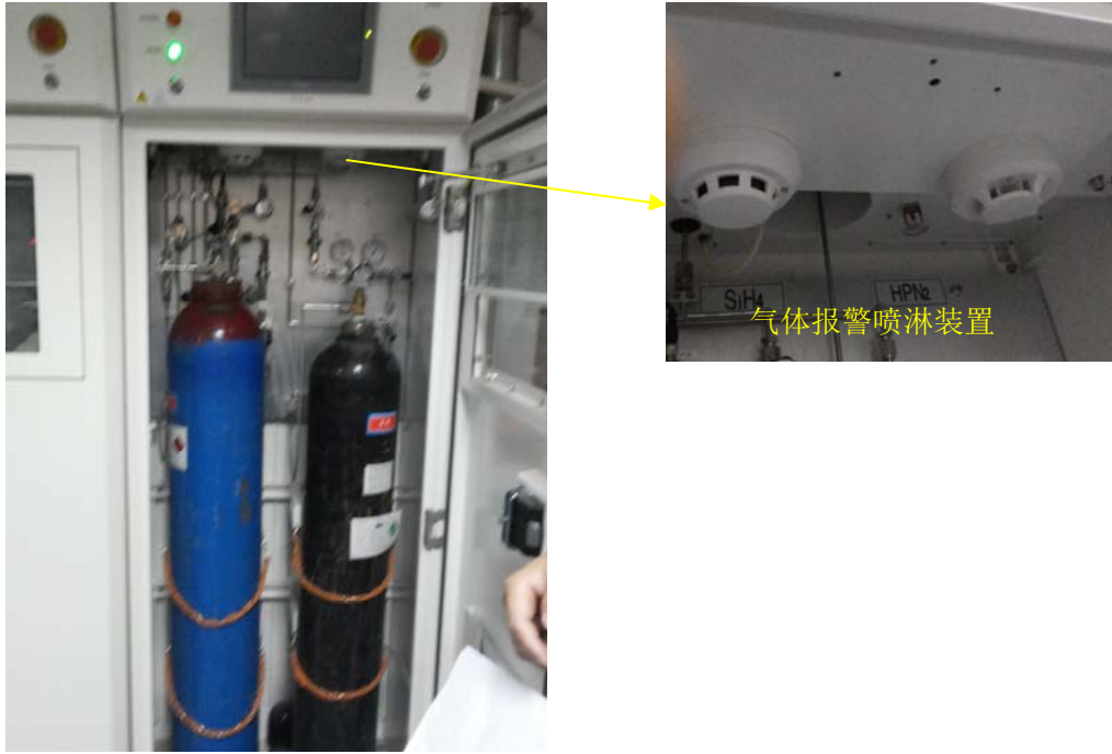
图 10-2 项目气体柜内气体报警及喷淋装置
