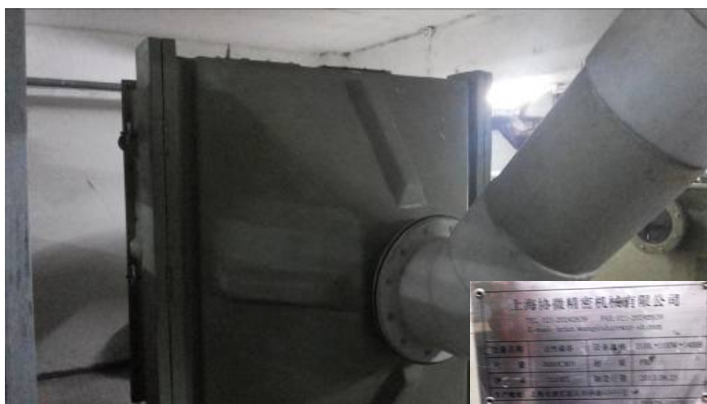
图 6-1 项目活性炭净化设施
